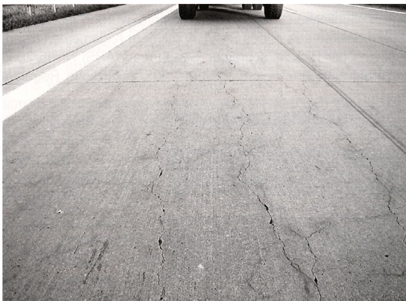
Obrázek 5 – Podélné trhliny cementobetonového krytu vozovky jsou protkány příčnými trhlinami
