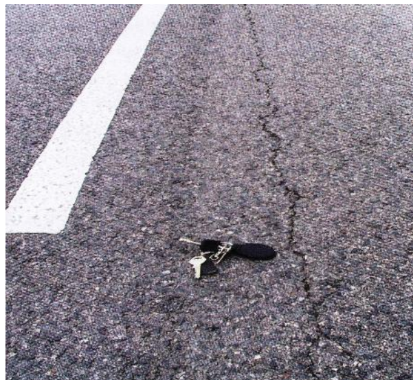
Obrázek 7 – Podélná trhlina na asfaltovém krytu vozovky, vzniklá v důsledku rychlého ochlazení a vyššího dopravního zatížení
